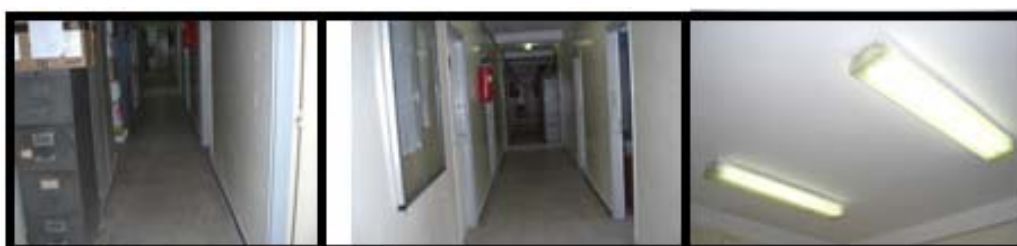
Figure 90: Couloirs sombres, besoin d'éclairage artificiel toute la journée (source d'apports internes) Source : personnelle
