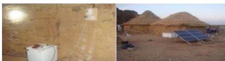
Figure 2.14 : Electrification par E.S. des postes de surveillance OPNT Illizi
