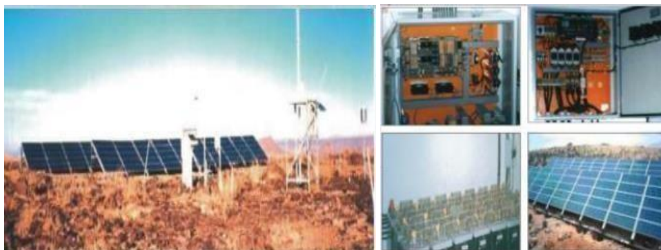
Figure 2.11 : Générateur photovoltaïque installé au centre de recherche de la station d'Assekrem– Tamenrasset
