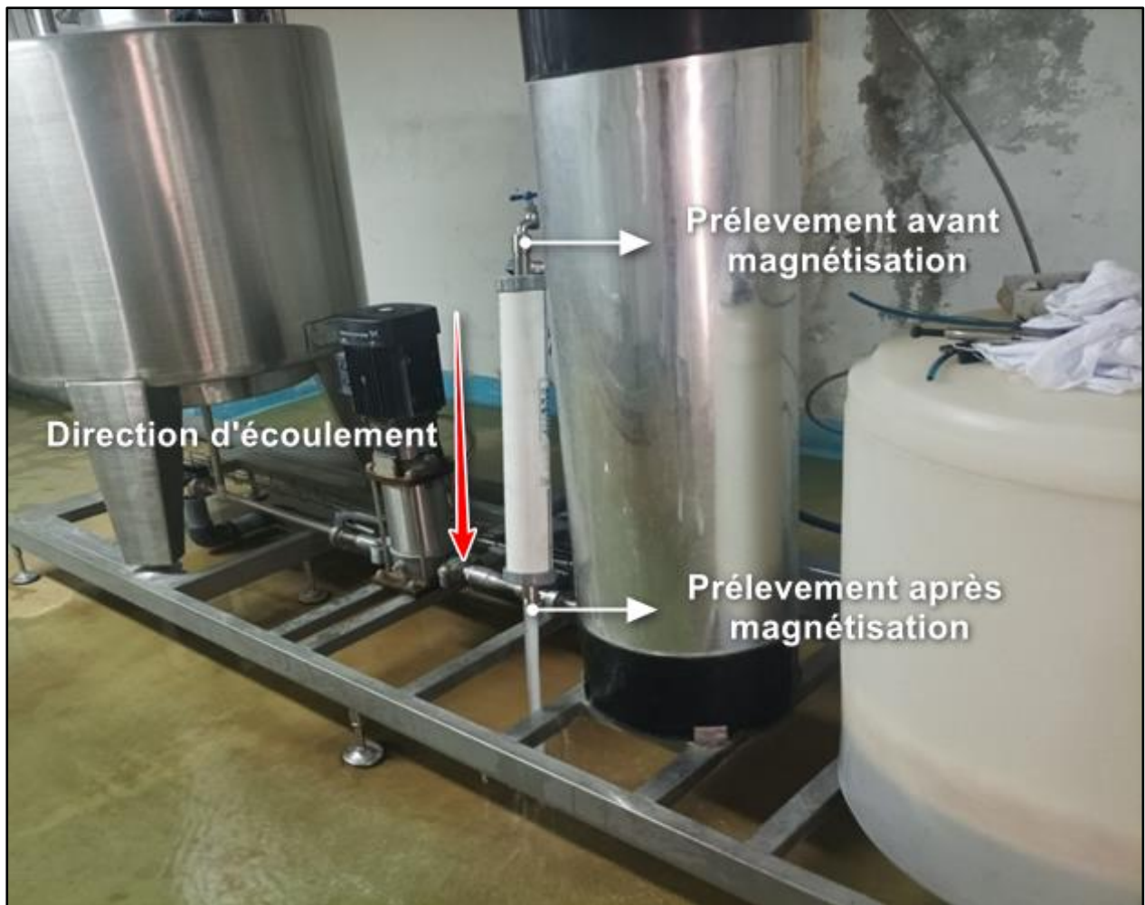
Figure 9. L'installation du magnétiseur au niveau de l'unité SAEMO SIDI RACHED.
