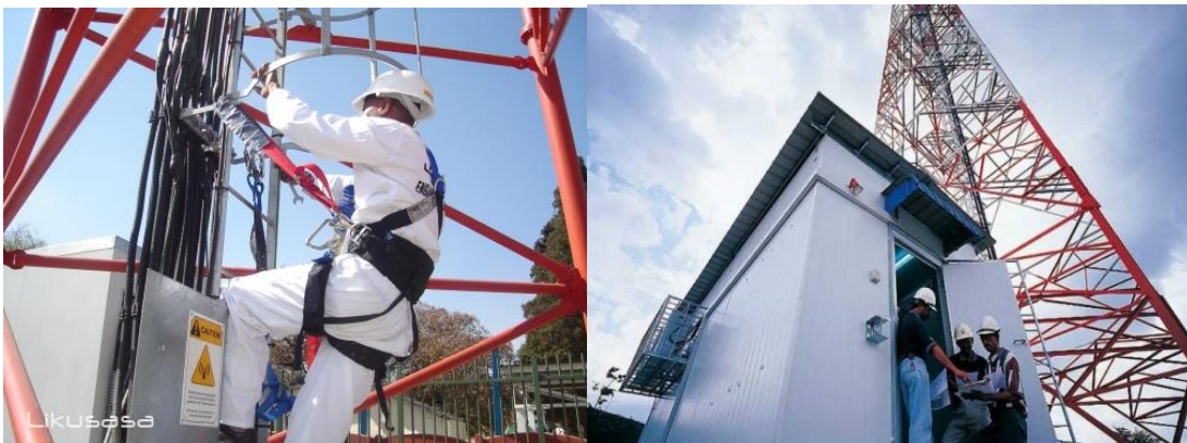
Figure II.14: Fin des Multi-installations liées au pylône.
