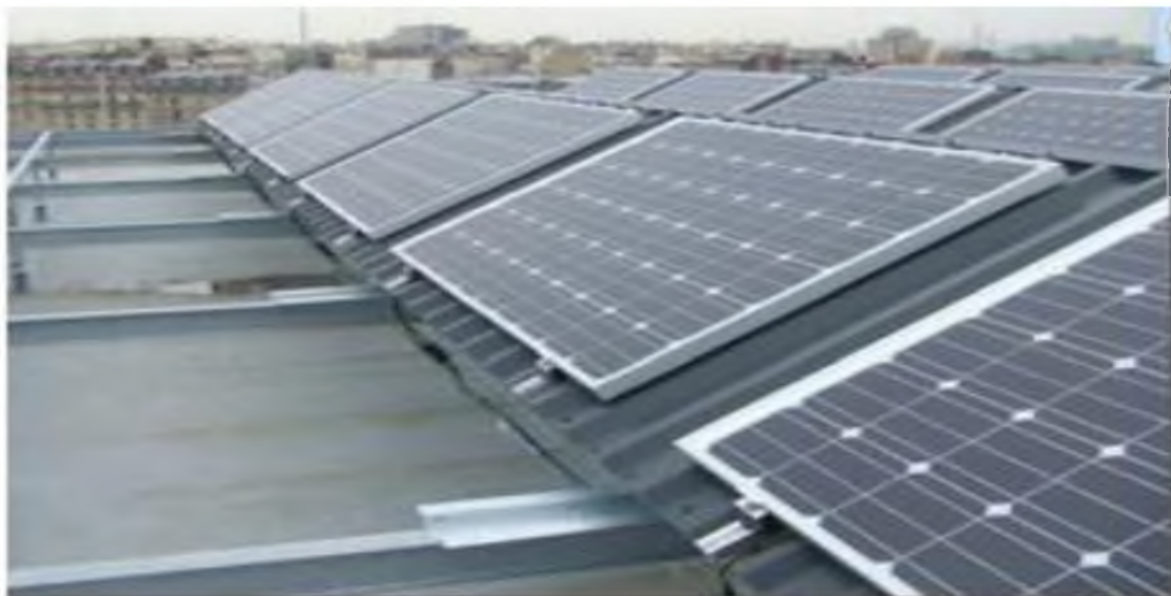
Figure 3.1 Installation photovoltaïque raccordée au réseau.
