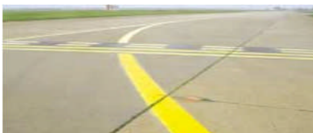
Figure VIII.8 : Marque de voie de circulation interrompue.
