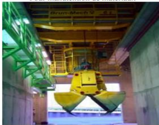
D - Pont roulant Pour les scories provenant d'incinération des déchets
