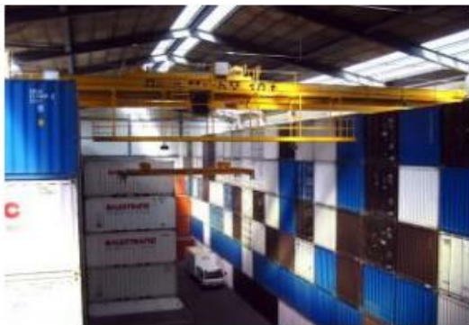
A - Pont roulant pour containers Halle de stockage
