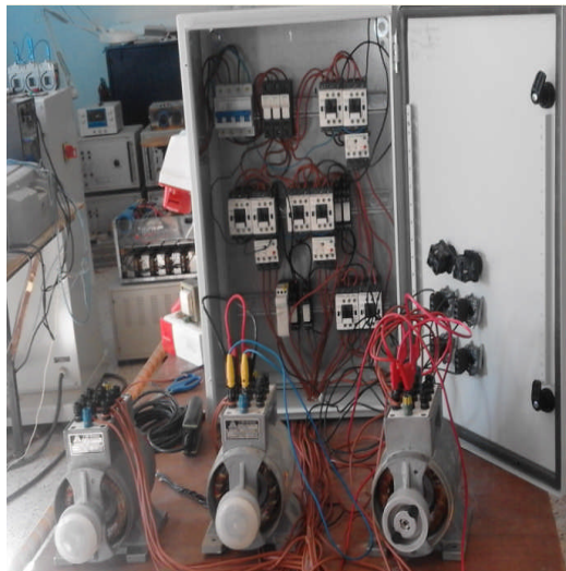
Photo. IV.3 : Vue de l'armoire avec les trois moteurs
