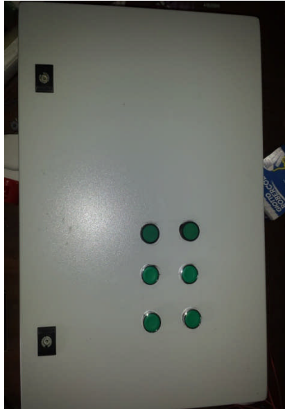
Photo. IV.1 : Vue extérieure de l'armoire
