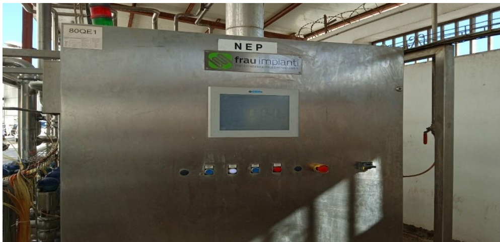
Figure 2 : Système de nettoyage en place (NEP) (photo original)
