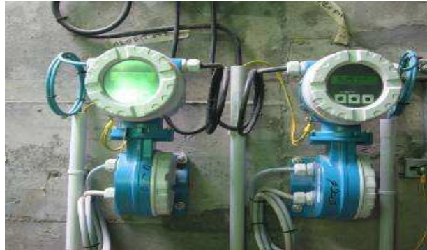
Figure II.5 : Débitmètres de dilution de chaux filière 1/ filière 2.
