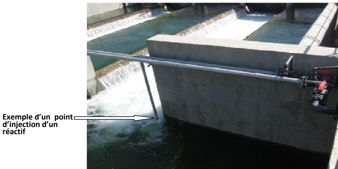
Figure I.3 : Entrée des chambres de mélanges.
