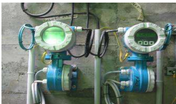
Figure II.5 : Débitmètres de dilution de chaux filière 1/ filière 2.
