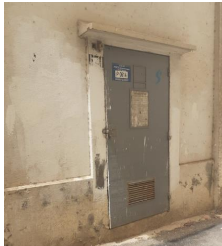
Figure 60 : post transformateur Source : Auteurs
