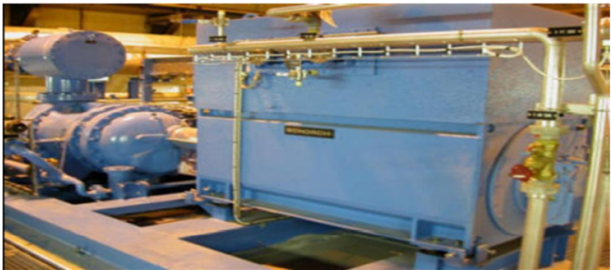
-Figure 4 : Une station de compression-
