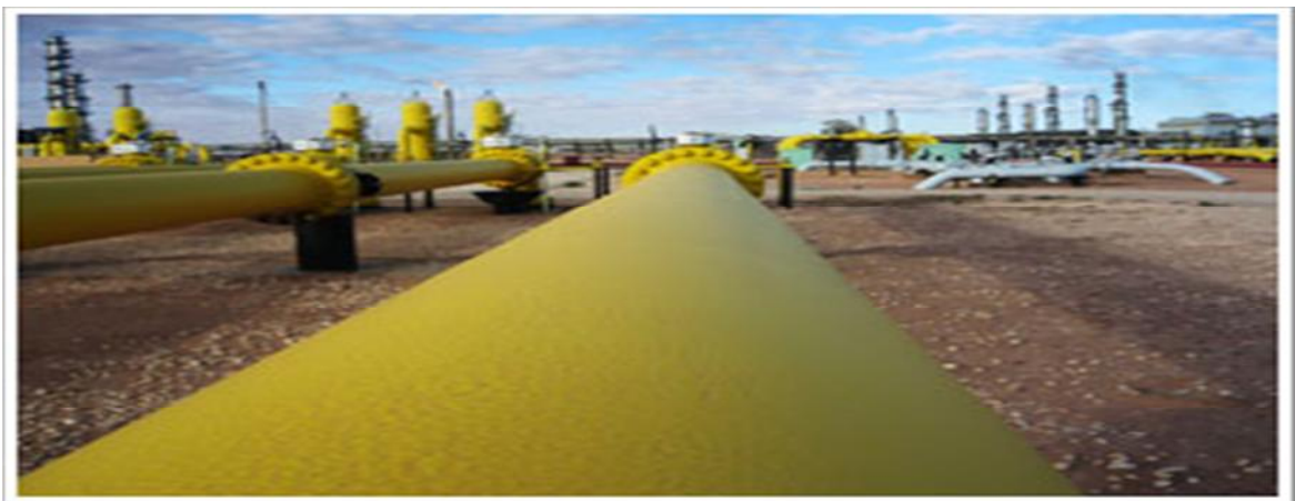
-Figure 3 : Une canalisation-
