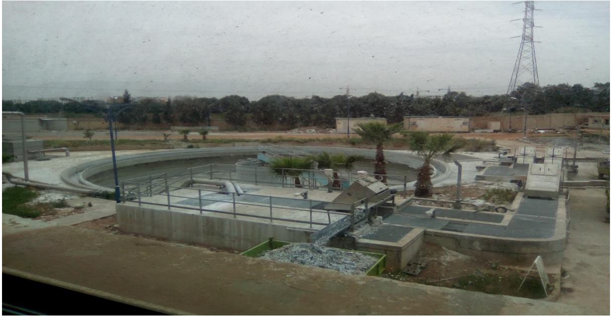
Figure 23 : Illustration de la station d'épuration des eaux industrielles Tonic industrie
