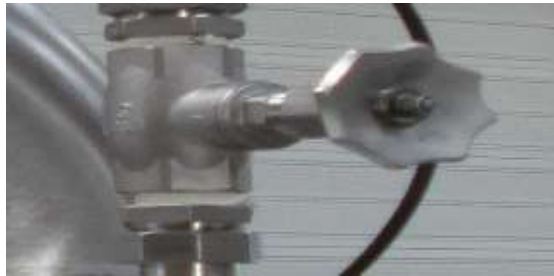
Figure I.19 : Vanne réglage débit Rinçage final réseau.
