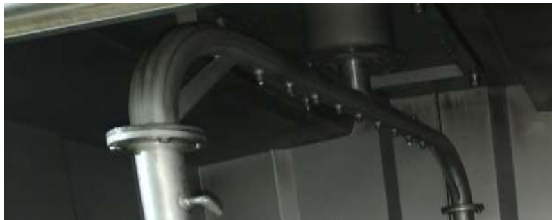
Figure I.24 : Rampe de rinçage fixe.
