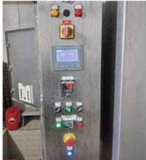
Figure I.31 : Coffret de commande.
