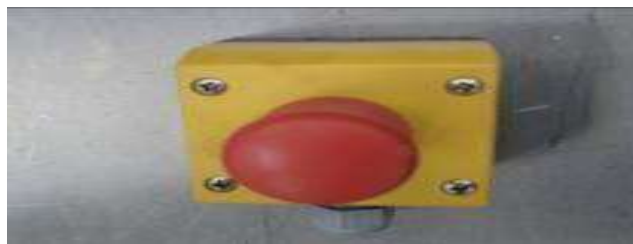
Figure I.32 : Arrêt d'urgence sur coffret.
