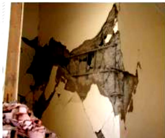
Figure I.10 : Fissures ouvertes dans le voile [1].
