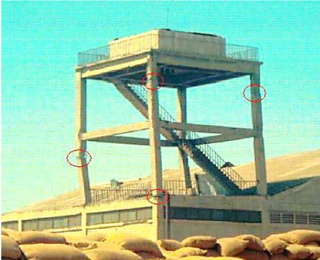
Figure III.1: Endommagement d'un portique à 2 étages par flexion dans les zones critiques des poteaux dans une installation portuaire lors du séisme de Buhj (Inde) 2001 [27].
