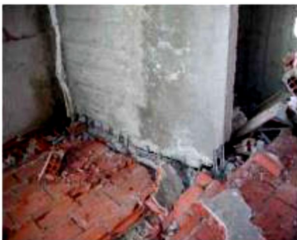
Figure I.9 : Rupture de section à la base des voiles [1].
