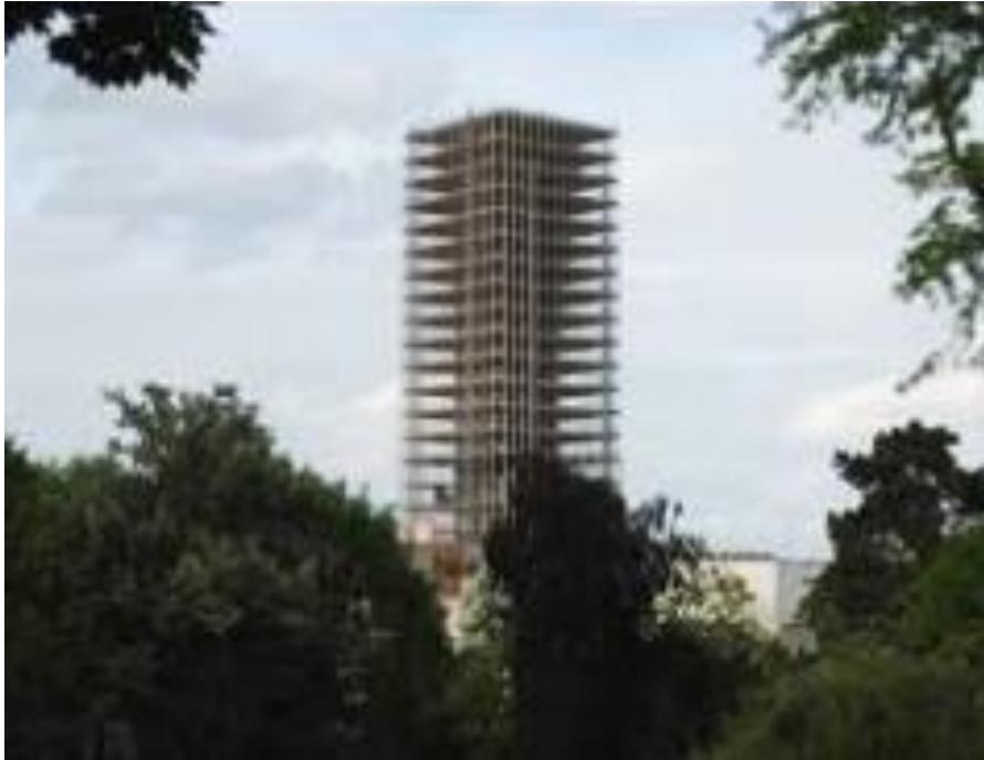
Figure I-16 : structure contreventée par noyau centrale en béton armé (La tour centrale de l'université de Jussieu en France) [5].
