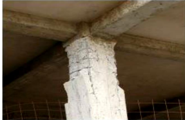
Figure I.7 : Décollement de l'enrobage [1].
