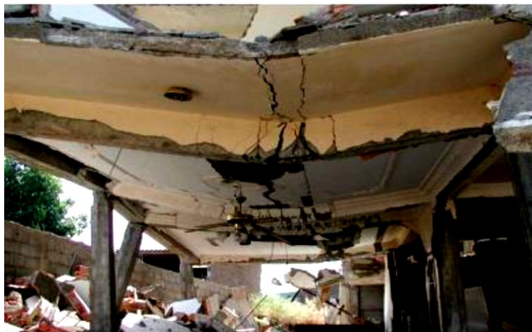
Figure I.8 : Rupture par flexion des poutres [1].
