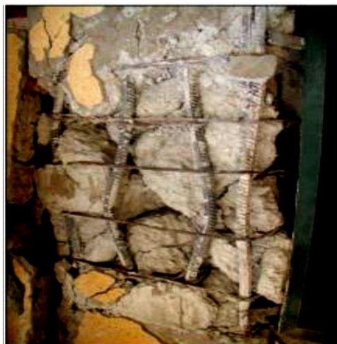
Figure I.6 : Ecrasement de béton et flambement des aciers dans les deux poteaux de la cage d'escaliers [1]
