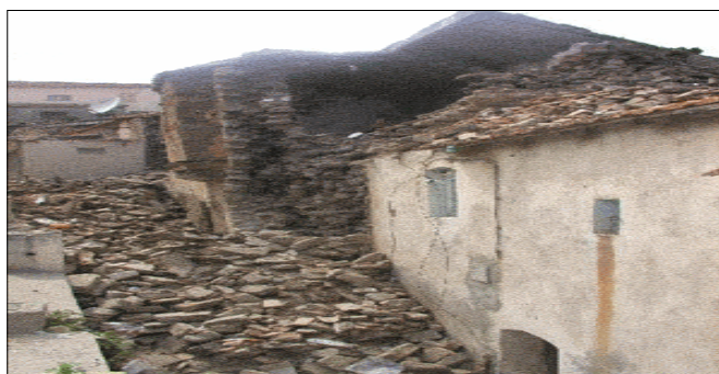
Figure 11 : Dégât causé par le séisme en 2003.
