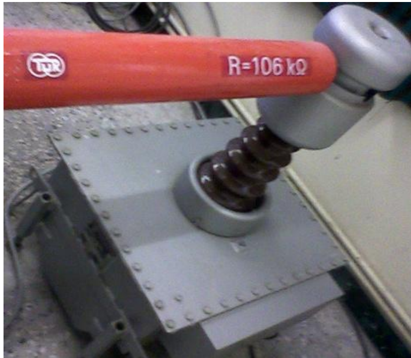
Figure III.8. Transformateur haute tension avec une résistance d'amortissement.
