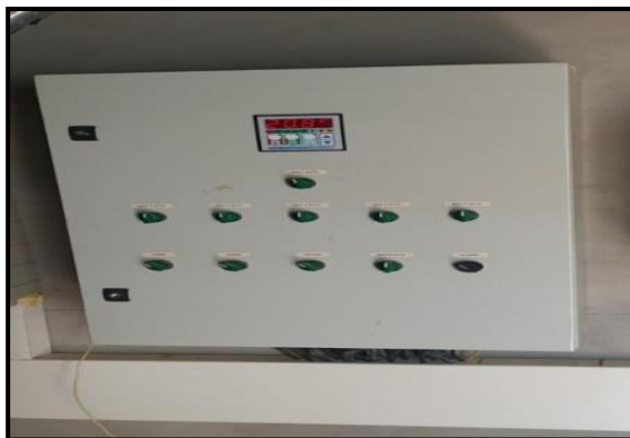
Figure 3.16 : Armoires des commandes tableau (Photo personnelle).
