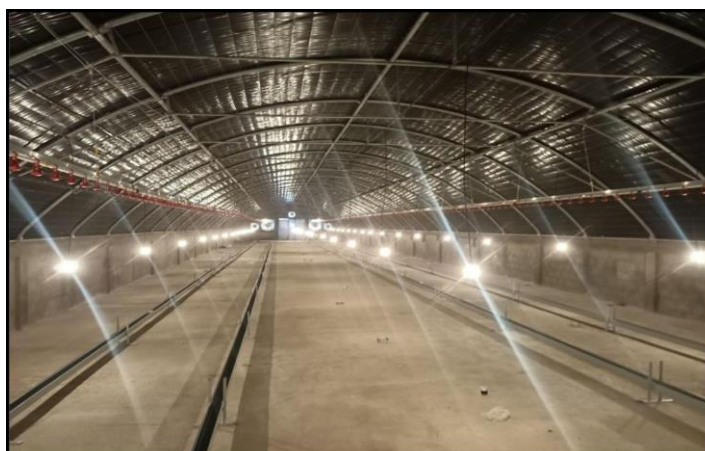
Figure 3.18 : système d'éclairage (Photo personnelle).
