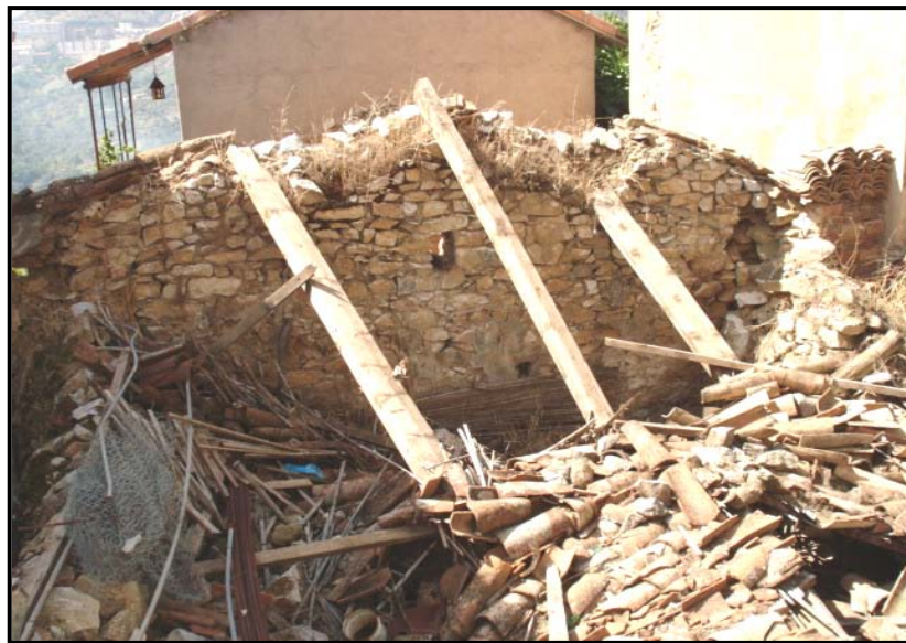
Photographie 6.1 : D'innombrables maisons traditionnelles à l'abandon et en ruine parsème le tissu villageois.
