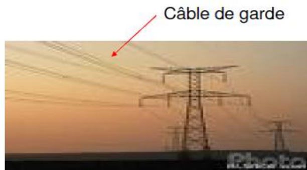
Figure I.15 : Câble de garde
