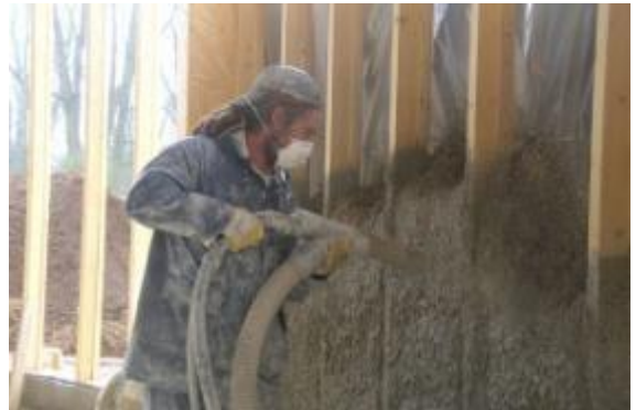
Figure 80 : Béton de chanvre Source: lemoniteur.fr septembre 2021
