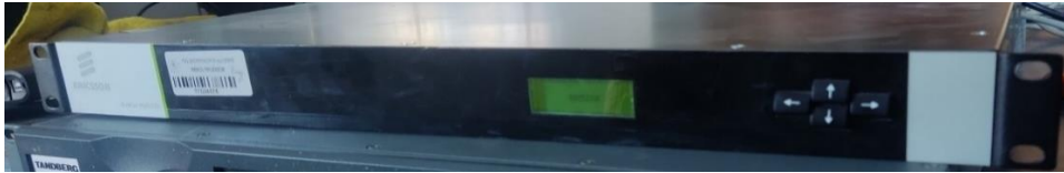
Figure 69: ReMultiplexeur utilisé de marque Ericsson.
