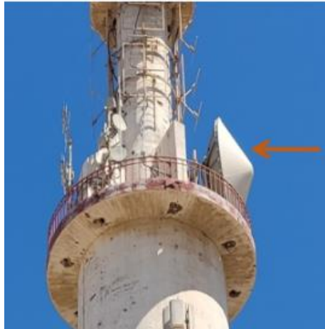
Figure 45 : Antenne de réception FH installée sur la tour au siège de la DRC.
