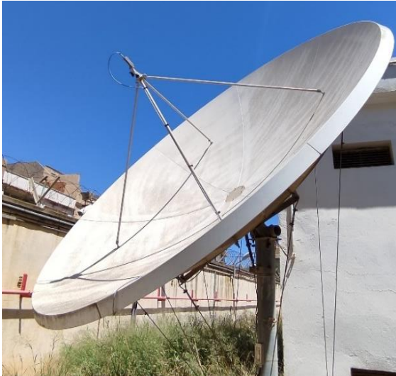
Figure 48: Antenne parabolique orientée vers le satellite ALCOMSAT-1 24.8°W.
