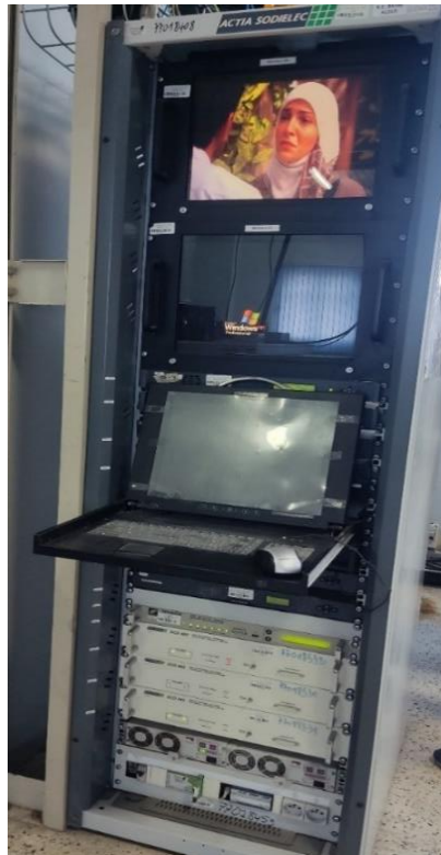
Figure 47: Une baie de multiplexage SODIELEC.
