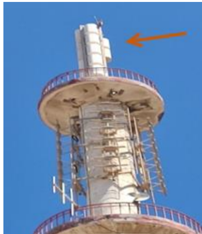
Figure 59: Panneaux d'antennes UHF.
