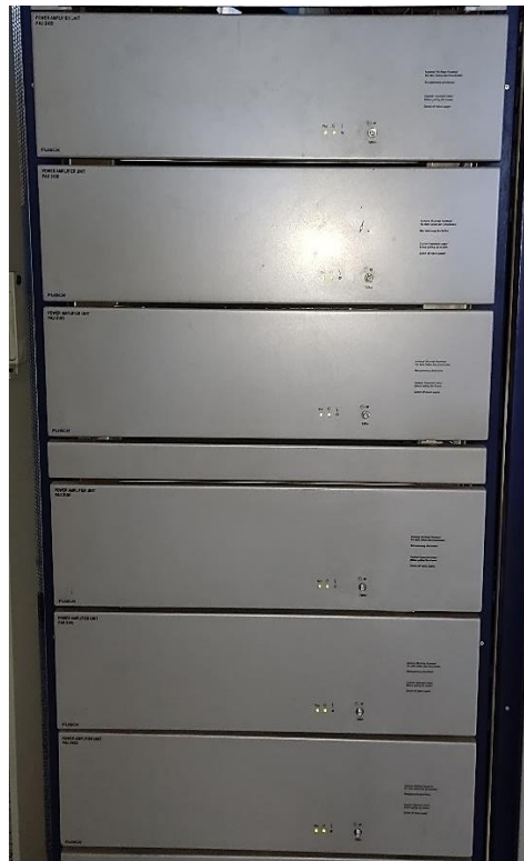
Figure 57: Les six amplificateurs de puissance RF PAU 3100.
