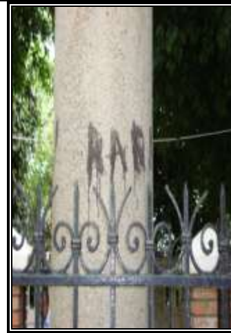
dégradation par des graffitis.
