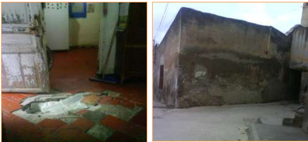
Photos 2.6 : Dégradation et effondrement du plancher à voutains.
