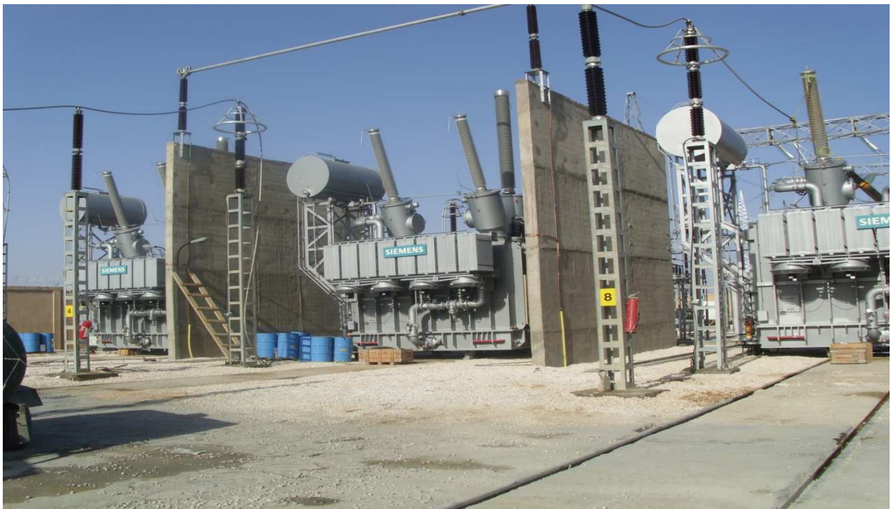
Figure I.9 : Autotransformateur de puissance pour l'étage 400kV
