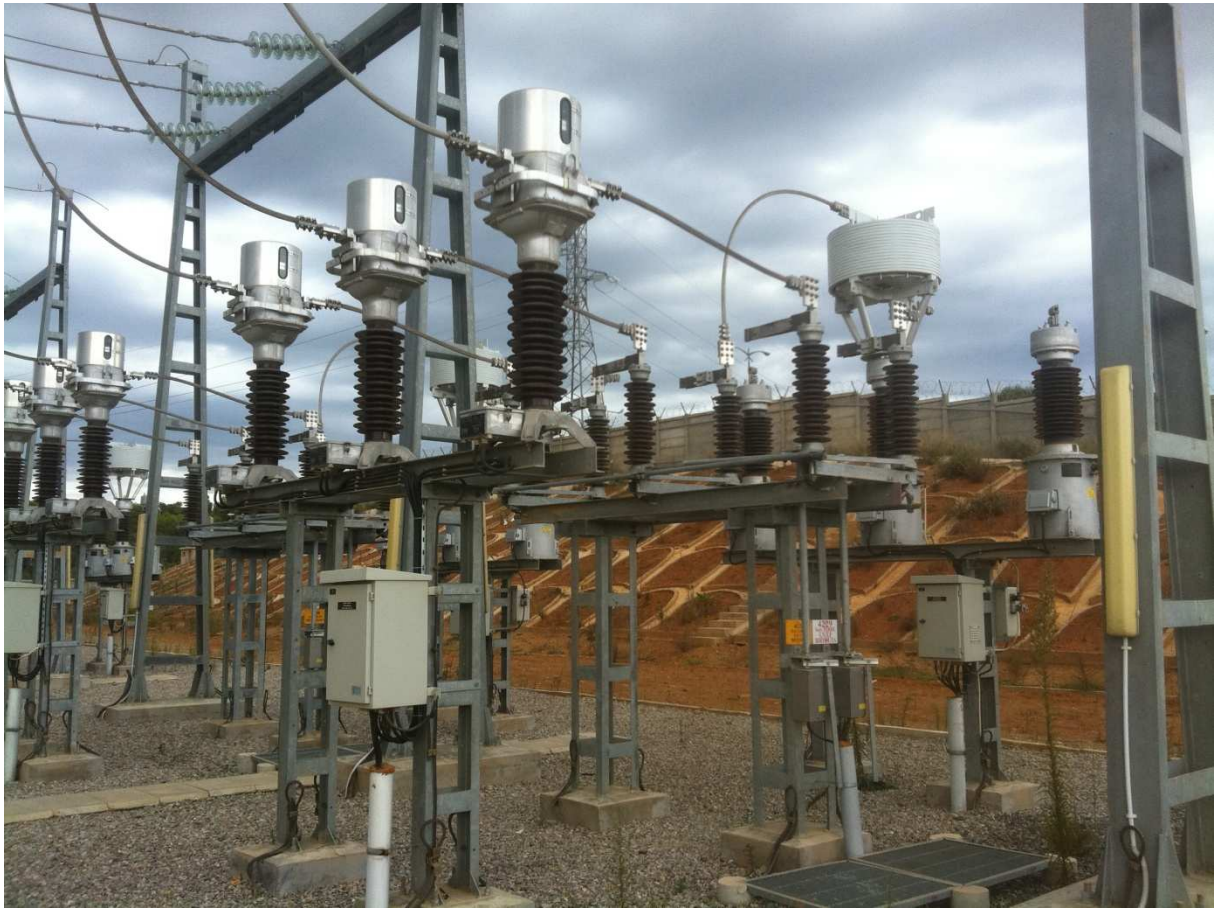
Figure I.14 : Transformateur de courant, de tension et circuits de bouchons
