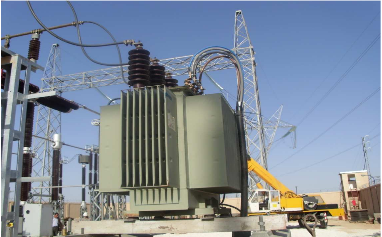
Figure I.10 : Transformateur des services auxiliaires TSA
