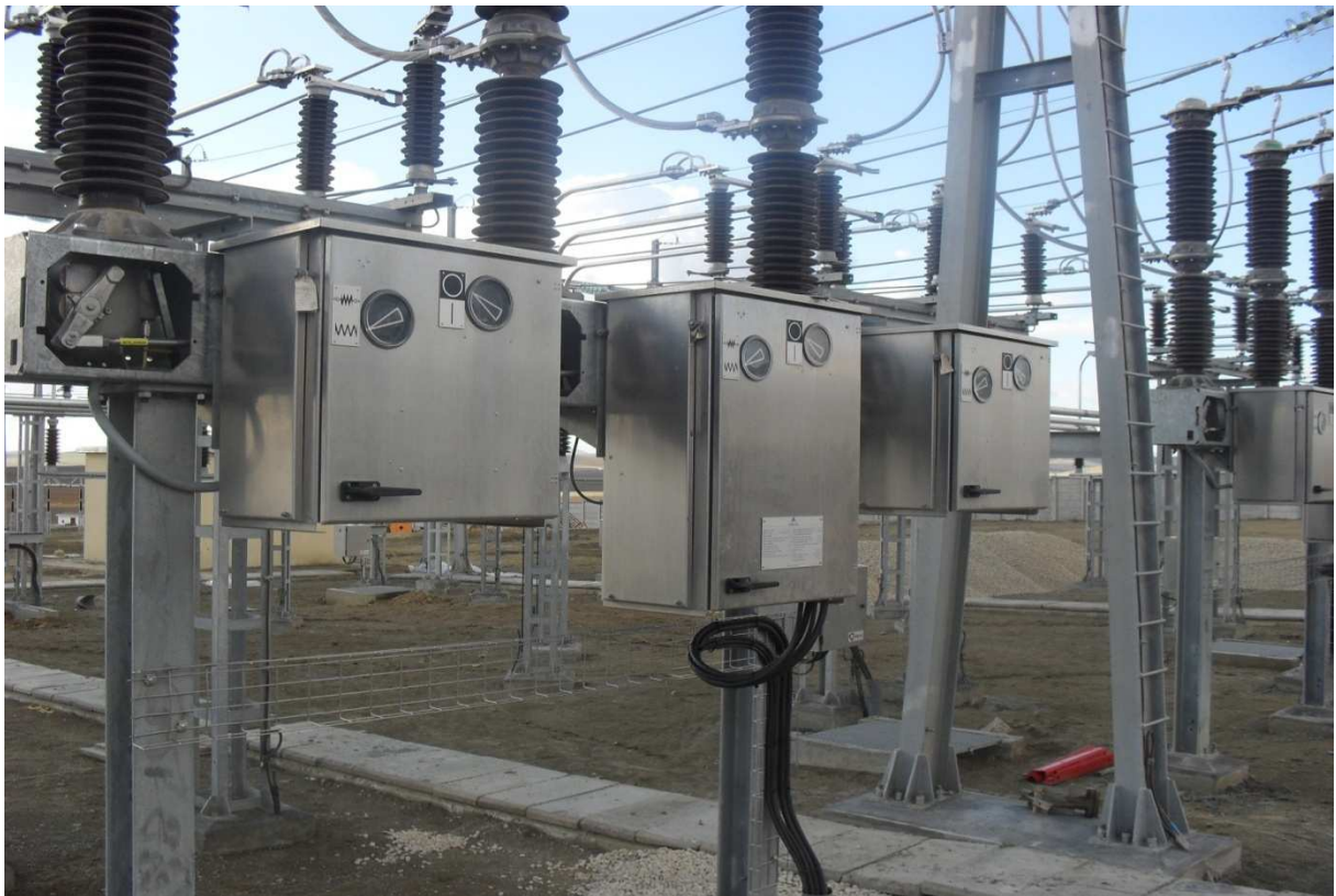
Figure I.12 : Disjoncteur à très haute tension
