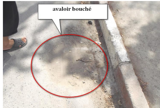
Figure II. 13 : avaloirs en mauvais état.
