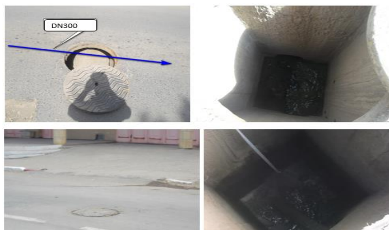
Figure II. 12 : regards sur le collecteur DN 300
