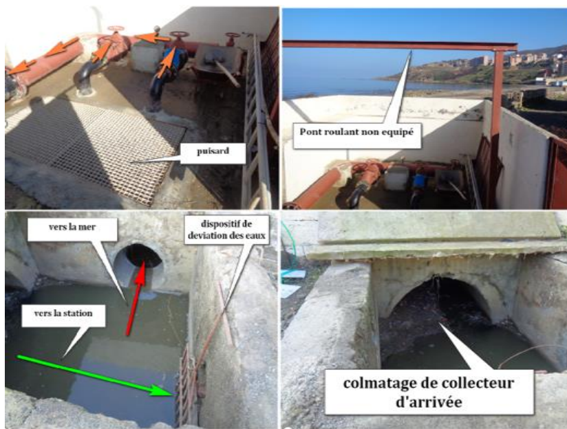
Figure II. 16 : Anomalies constatées lors de la visite de la station de relevage N°1
