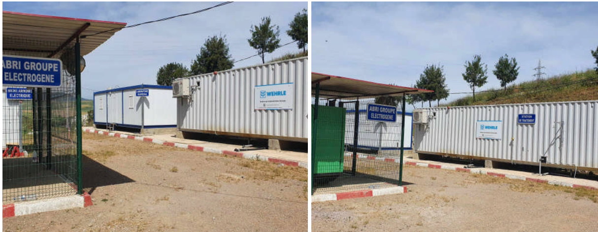
Figure N°23 : La station de traitement du lixiviat
