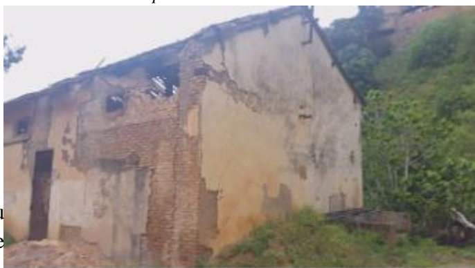
Photo79 Dégradation très avancée dans les murs est du a la pénétration de l'humidité qui détériore le liant entre les briques rouge source : auteur
