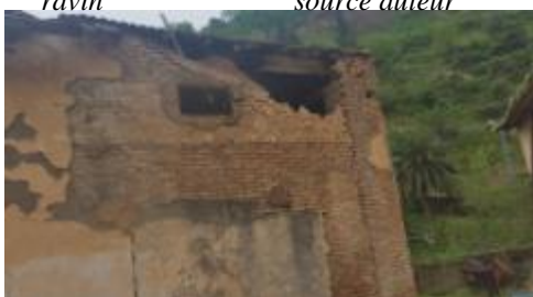
Photo 78 Dégradation très avancée dans les murs est du a la pénétration de l'humidité qui détériore le liant entre les briques rouge source : auteur
