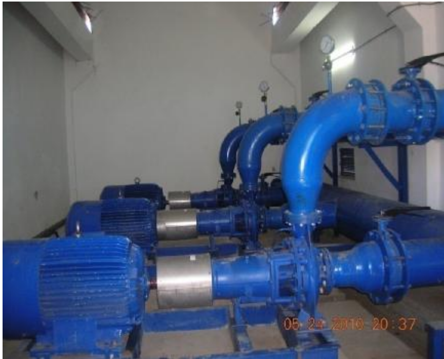
Figure 1.14 : La chambre de pompage de SR0.
