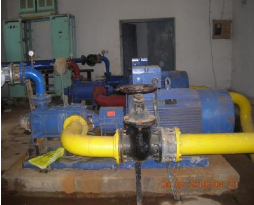
Figure 1.16 : La chambre de pompage de SR4
