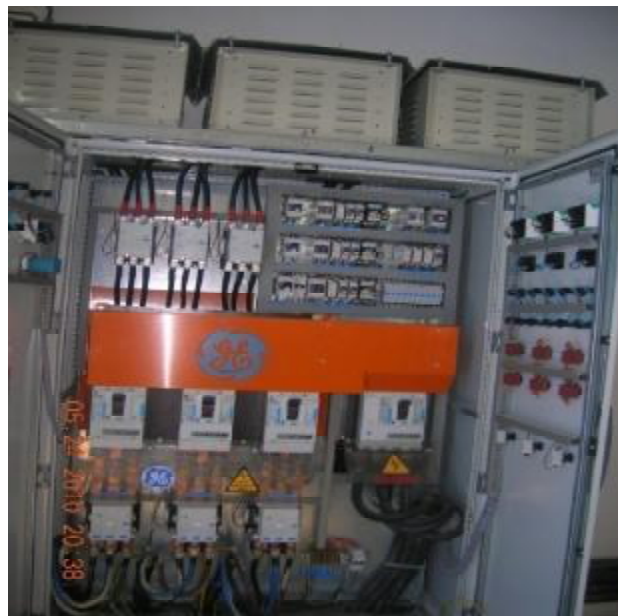
Figure1.4 : Armoire de commande
