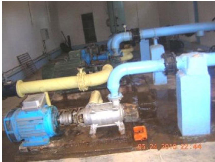
Figure 1.15: La chambre de pompage de SR1.
