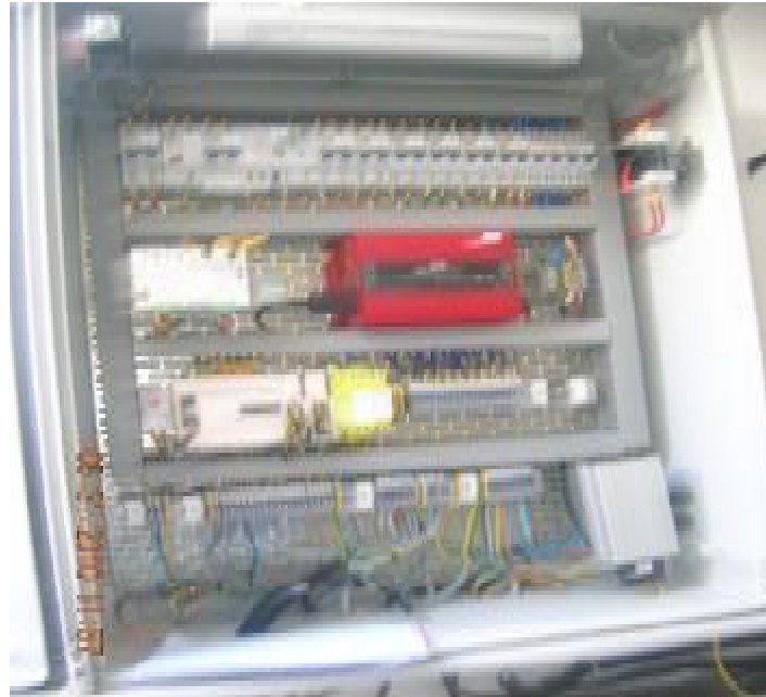
Figure 3.11 : Photo de l'armoire de commande d'un réservoir
