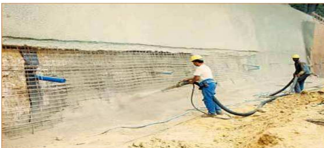
FIGURE III.9 Géo-synthétiques drainants disposés en bandes verticales entre le terrain et le parement.
