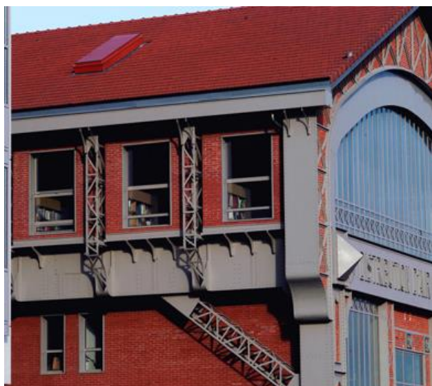
Photo II-7 : La charpente réparée de la halle Source : balisejaune.blogspot.com .
