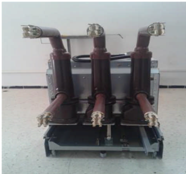
Figure 2.9 : Disjoncteur d'un départ d'un poste HTA installé dans la cellule.
