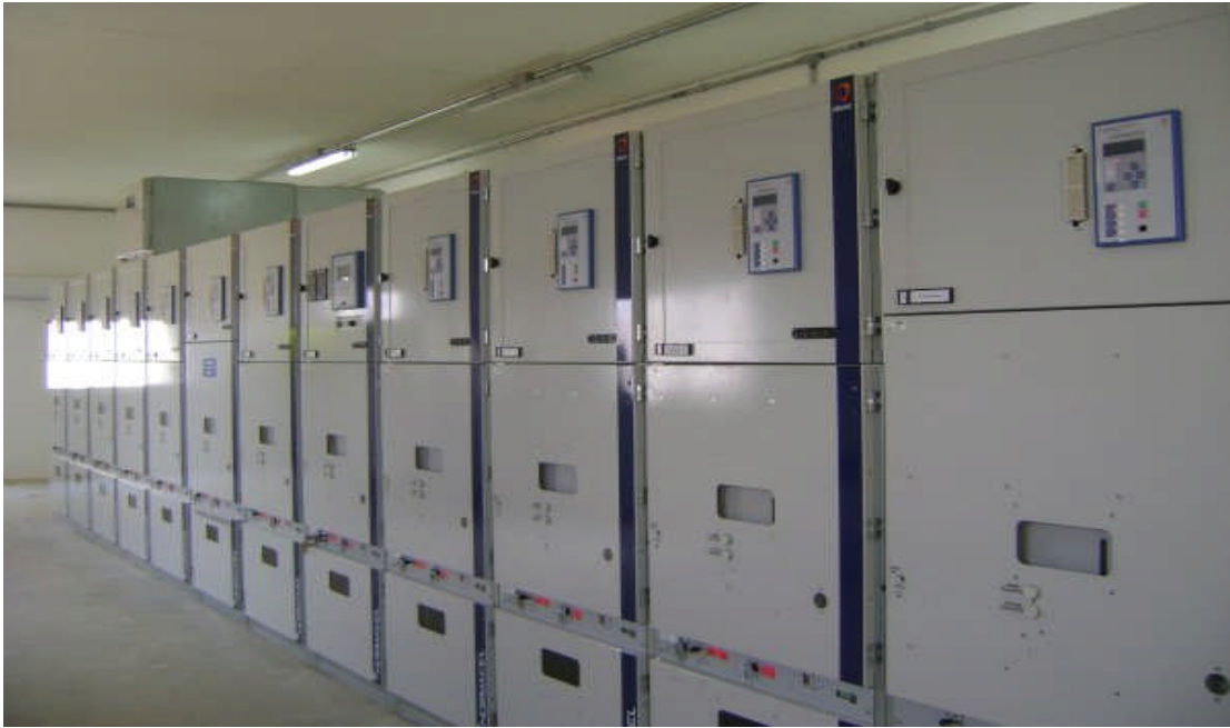
Figure 1.3: Cellules d'un Poste HTB/HTA
