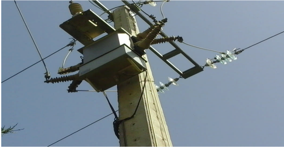
Figure 2.10: Interrupteur aérien automatisé
