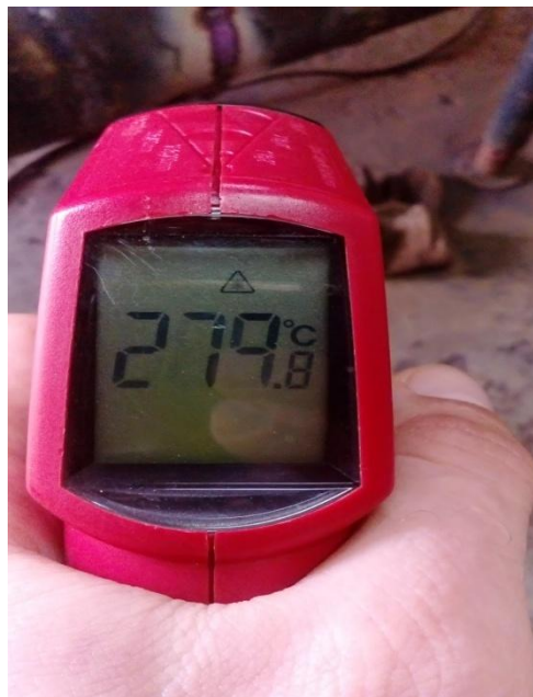
Figure 3.4 : Température et couleur d'un cordon de soudure après quelques secondes de fin de soudage.
