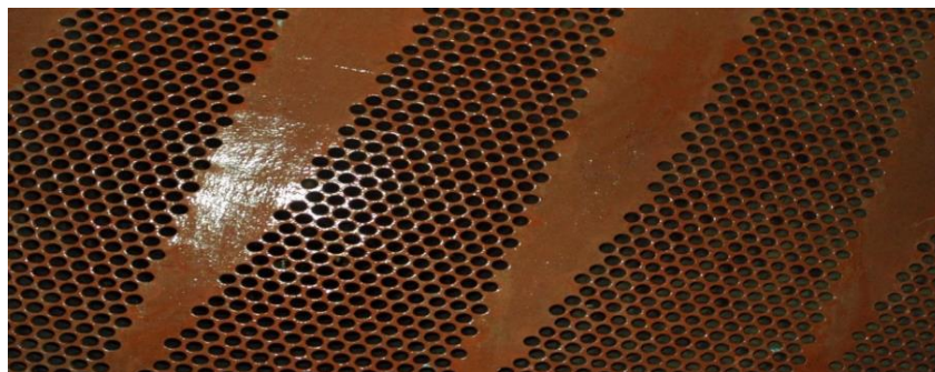
Figure I.10 : Vue intérieure du condenseur
