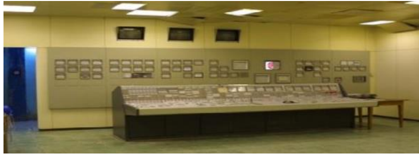
Figure I.15 : salle de commande
