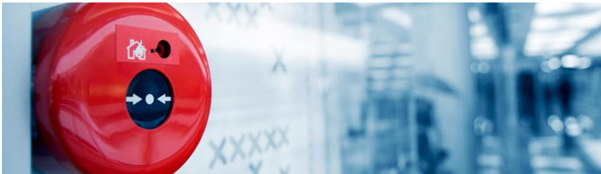
Figure.I.10. Alarme [Officiel Prevention]
