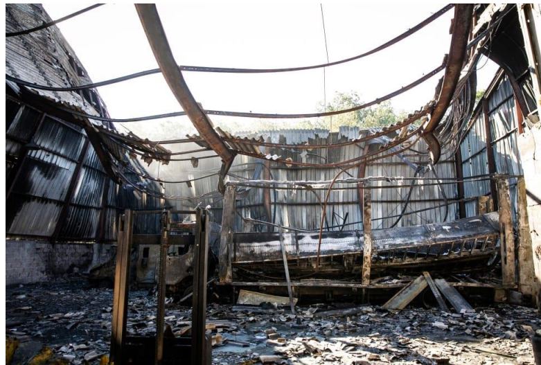
Figure.I.6. Entrepôt de Saint-Benoît détruit après un incendie [La Nouvelle République]
