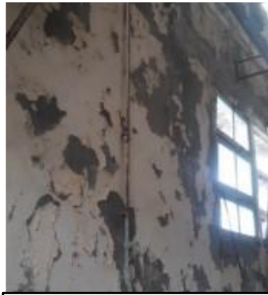
Photo 1 - écaillage mur intérieur de l'atelier
