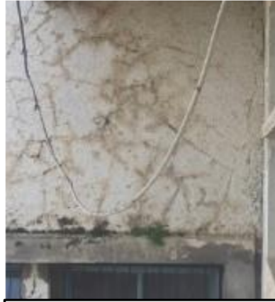
Photo 2 - faïençage et microfissure mur extérieur de l'atelier
