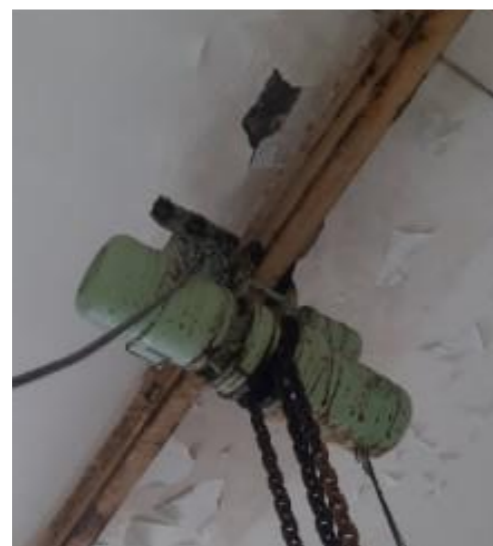
Photo 10 - monte charge fixé au plafond
