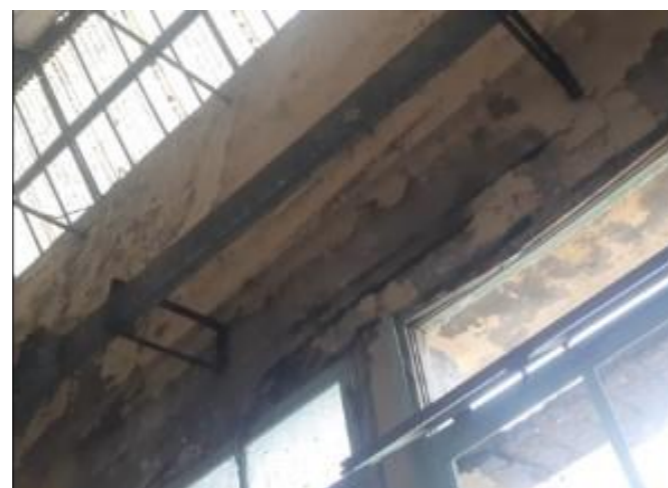
Photo 7 - fissure au niveau des linteau de fenêtres
