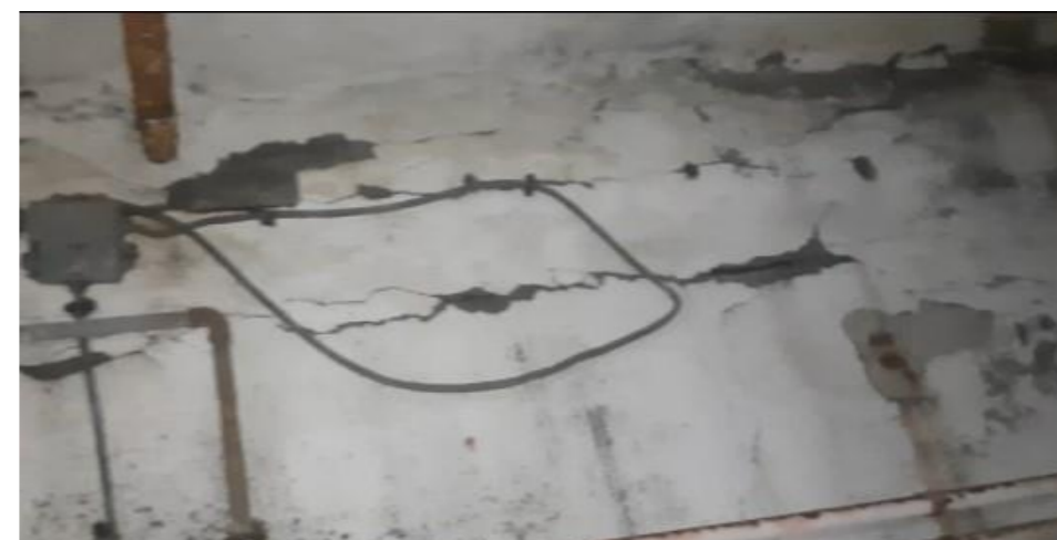
Photo 8 - fissure horizontale au plancher du sous sol
