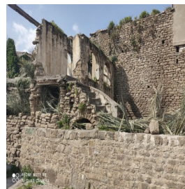
Figure 103 : bâtisse partiellement effondrée. Source : auteurs.
