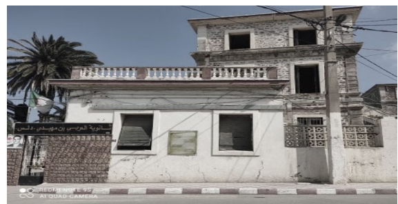
Figure 105 : Bâtisse présentant des anomalies structurelles. Source : Auteurs.
