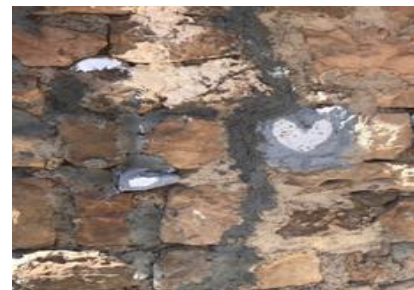
Figure.53: Altération lors de réhabilitation. Source : Auteurs.
