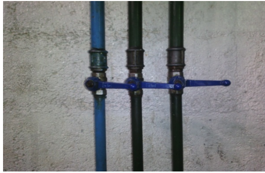
Figure I.12 : Vannes d'eau et d'air de la machine
