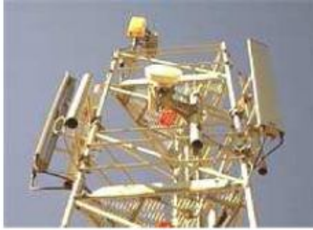
Site bisectorisé avec 2 antennes-panneaux directionnelles
