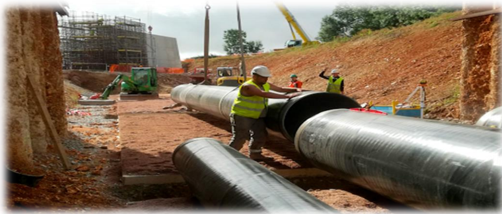
Figure IV. 4 : Conduite en acier
