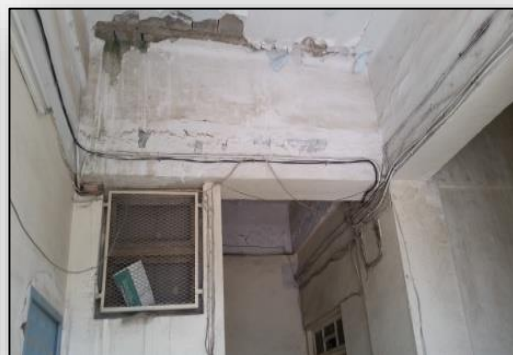
Figure 44 : infiltration des eaux au niveau des planchers source: auteur
