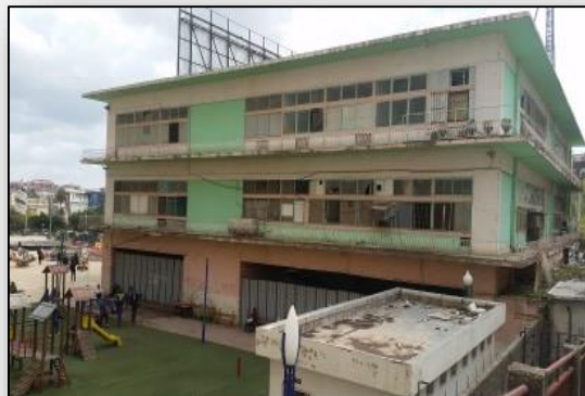
Figure 42 : état de vitrage d'ouvertures source: auteur
