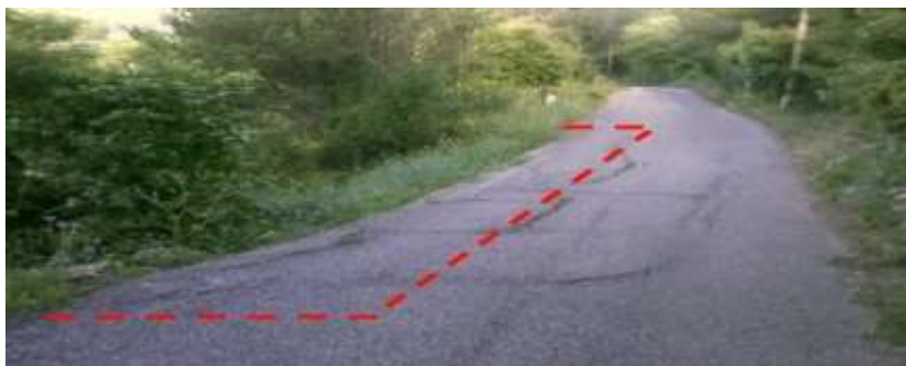
Figure I.13: Affaissement de rive. ( MAIRIE D'EVENOS 2024)
