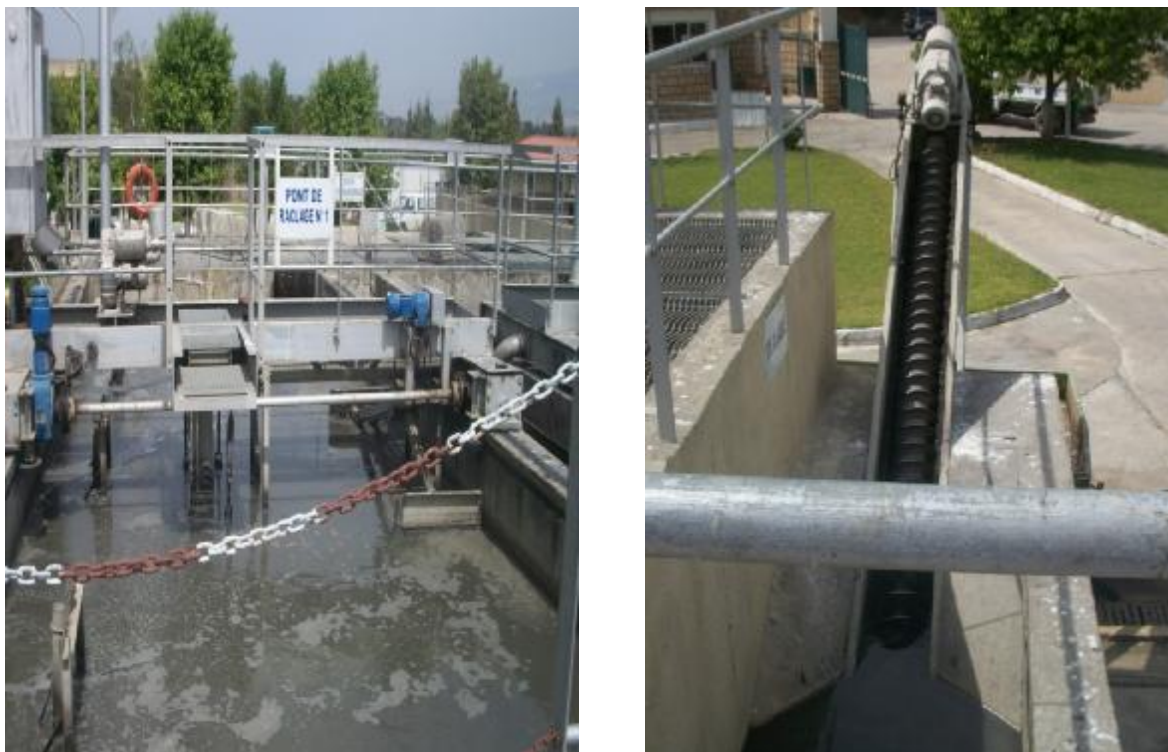
Figure06 : Racleur de la station ONA.
