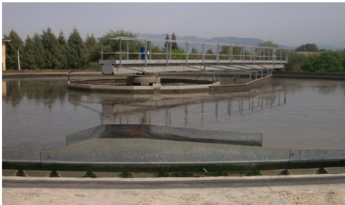
Figure08 : Le clarificateur de la station ONA.
