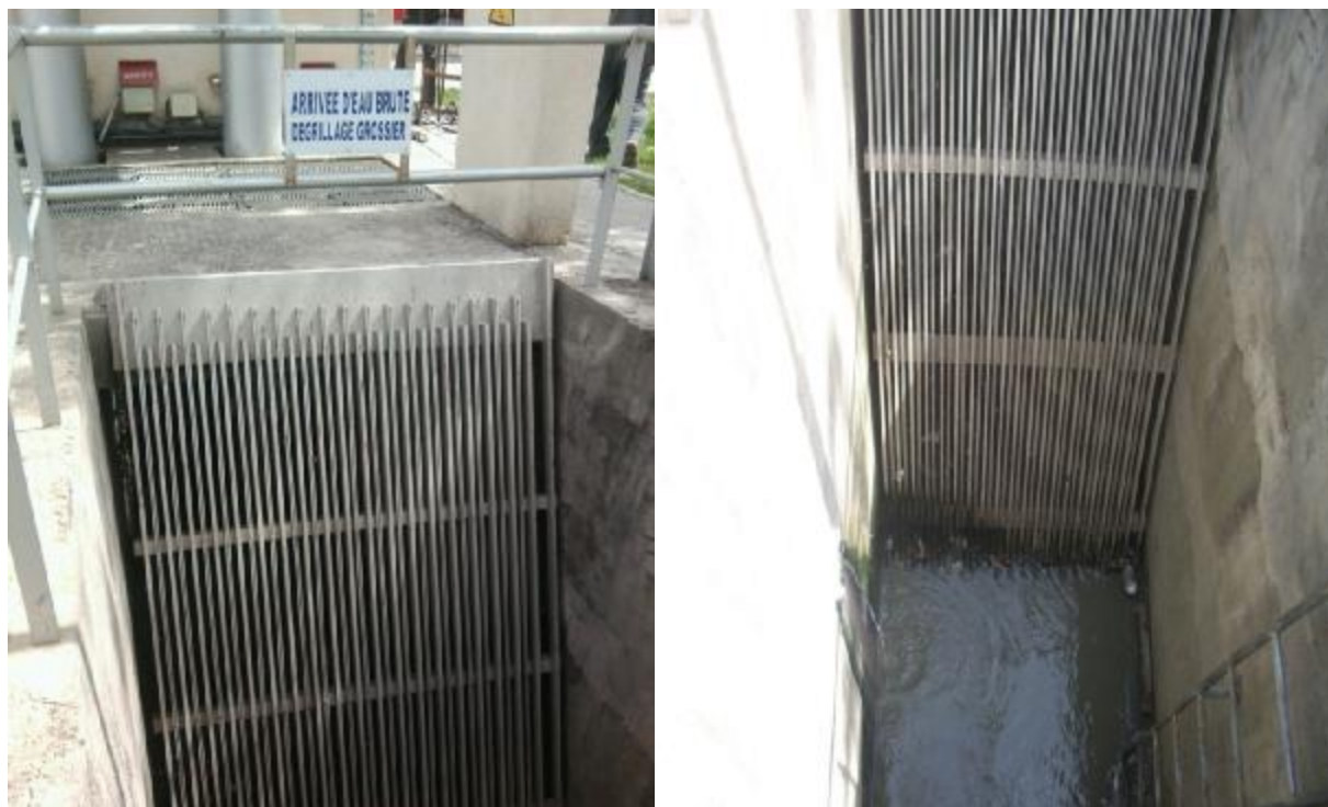
Figure04 : Dégrilleur de la station ONA.
