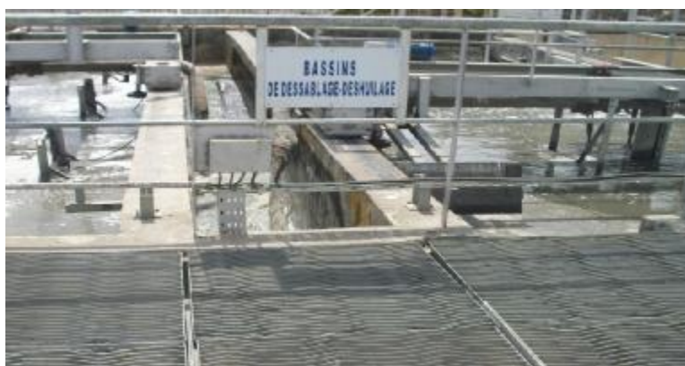
Figure05 : Le bassin de dessablage-déshuilage de la station ONA.
