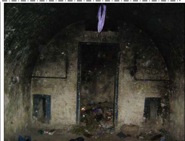
Photo 2.20 : L'état de la batterie du centre. Bejaia
