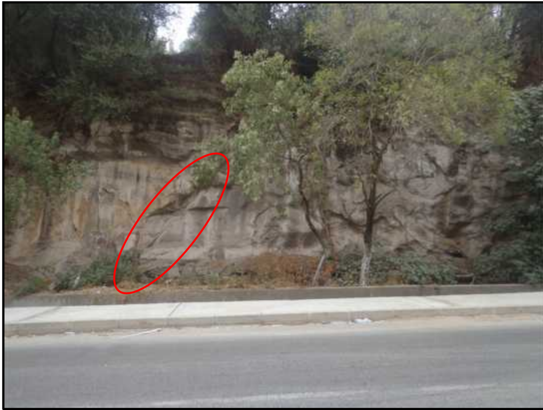
Figure IV. 15: photo montrant un décrochement au niveau des grès du côté Sud de Meddouha
