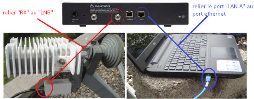
Figure IV.29 : câblage du routeur avec le PC et l'antenne VSAT.
