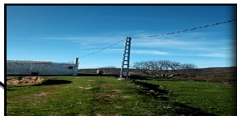
Figure 49 : ligne électrique de moyenne tension source : auteur
