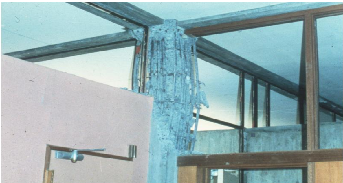
Figure I.10 : Rupture par écrasement du béton du au remplissage partiel.[23]
