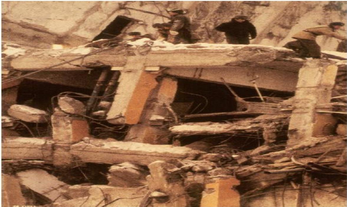
Figure I.6 : Rupture fragile de portiques de béton armé (Arménie) Conception incorrecte des armatures [23]
