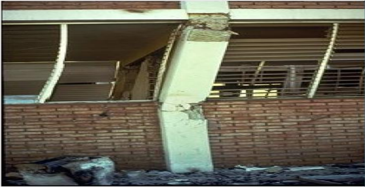
Figure I.9 : Cisaillement du poteau dû au remplissage partiel.[23]
