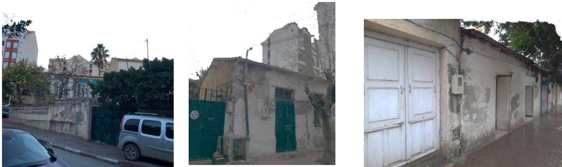
Figure II 90 Bâtie coloniale en dégradation, source : auteur
