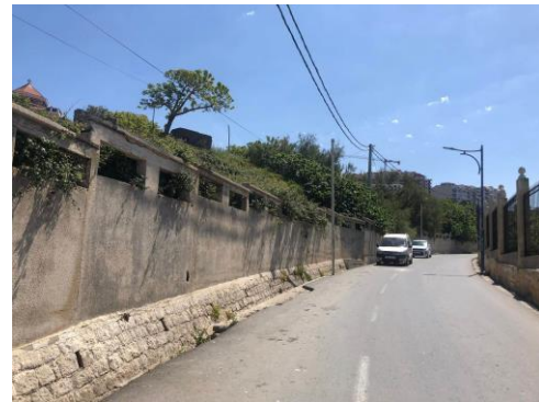
Figure III 99 La rue 11 décembre 1960 avant intervention , source : auteurs
