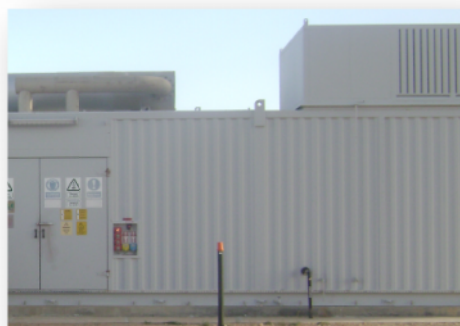
Figure I-8 : Générateur diésel de secours
