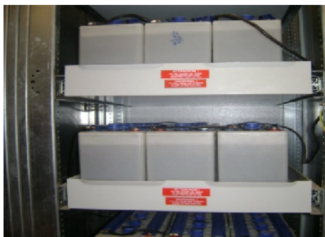
Figure III.1 Vue des étages de batterie
