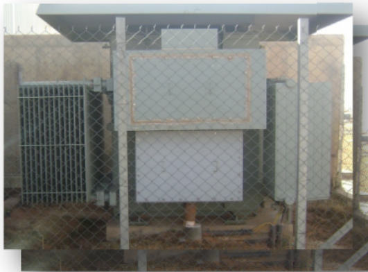
Figure I-7-a : Transformateur ALSTOM 30KV/0.415V
