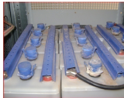
Figure III.2 vue d'un étage de batterie
