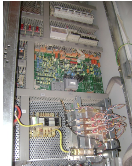
Figure I.9.b : UPS vue de l'intérieur
